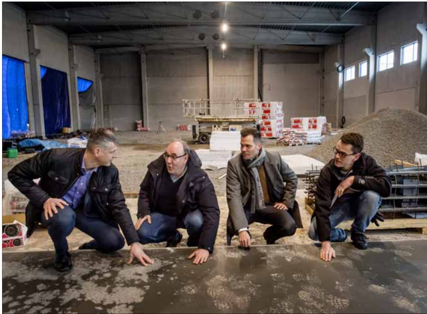
Kim Westerlund (vas.), Göran Tylli, Jyrgen Wiklund ja Tommi Grankulla suunnittelivat yhteistyössä Tylliksen mittavan laajennusosan, jonka lattian sementtivalua miehet torstaina ihailivat. Kesään mennessä valmistuva laajennus on kolmen tuhannen neliön kokoinen. KP/MARKKU JOKELA
